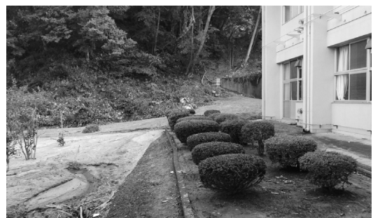
宮古商業 校舎西側斜面が崩れ校舎に泥が流入(9/2撮影)
